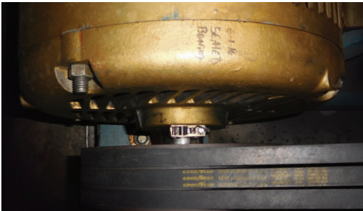
BPK-4 on Air Handling Unit Fan Motor
